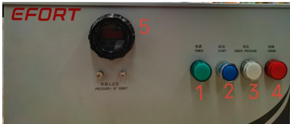
图 4.9.5 防爆柜外部指示灯
