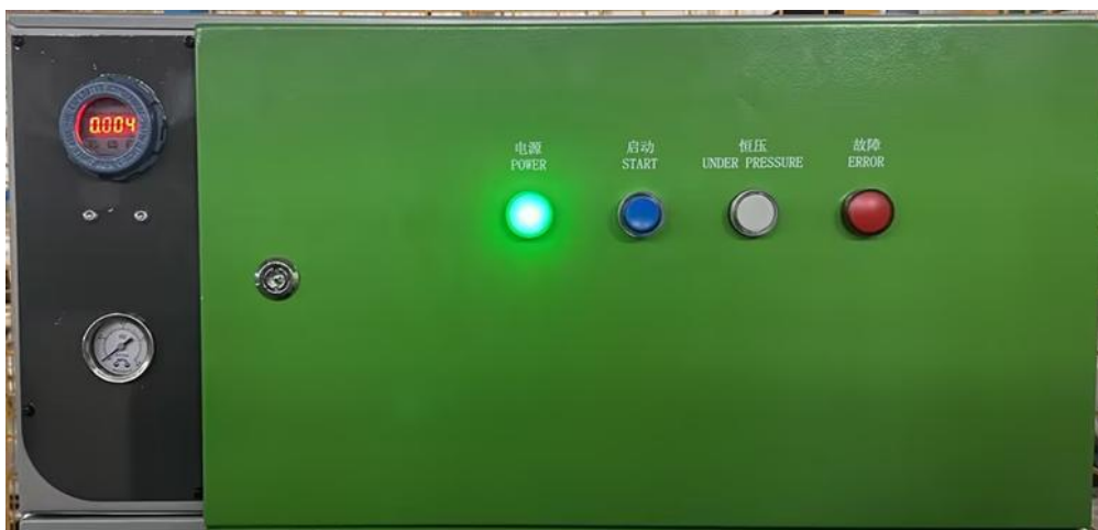
图 2-2 防爆电柜的外部结构
