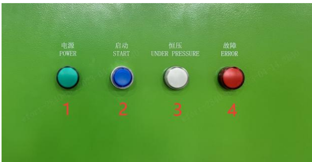
防爆电柜的外部指示灯布局
