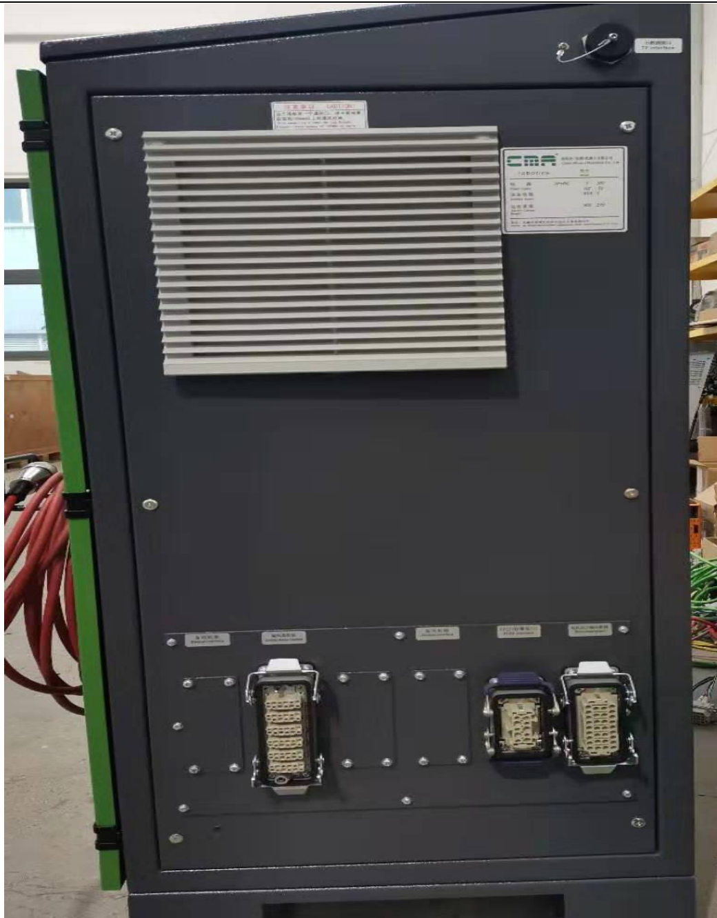
电柜右侧面相关元器件布局与安装
