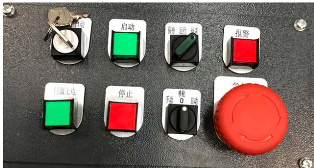
Figure252: Control panel on electrical cabinet 电柜上的控制面板
